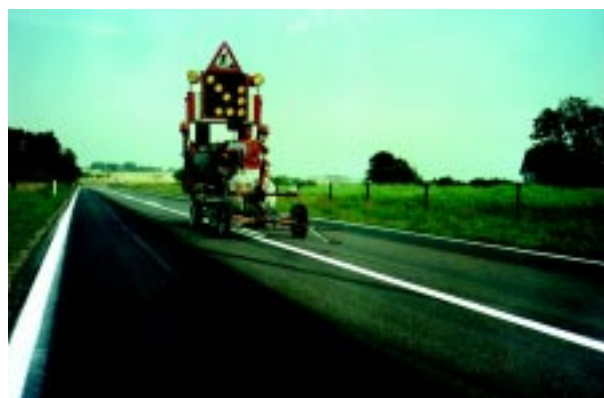
Applicering av vattenburen Mercialin AQ-BST i Danmark. Uppställning av skyddskoner samt följevagn med upplysning "akta linjen" till trafikanten behövs ej, eftersom färgen är snabbtorkande.
